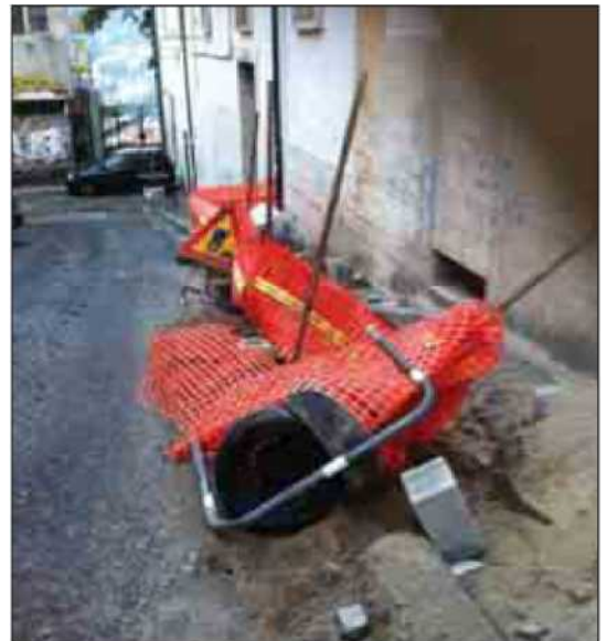
La caduta di calcinacci in via del Popolo e il cantiere in via IV Novembre
